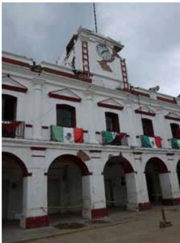
Palacio Municipal Juchitán de Zaragoza, tomado de Google Maps, después del sismo del 7S. Google Maps septiembre 2017
